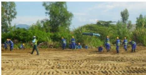
Trồng cỏ mới ở Khu Pha trộn và Chuyển tải trước đây (Ảnh: CDM Smith)
